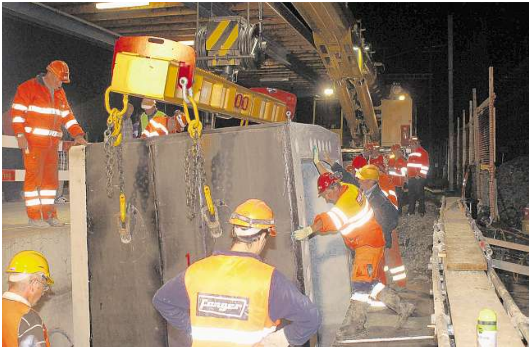
Die Betonelemente werden eingesetzt: Die 25 Tonnen schweren Kolosse werden in die Baugrube gesenkt.
