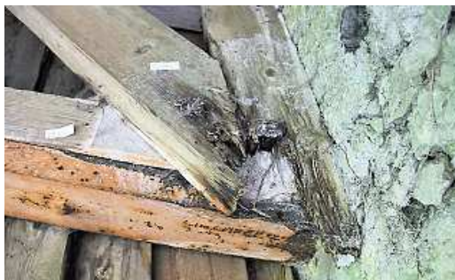
Kritisch: Mit solchen Verbindungen (hier am Tragwerk) ist klar keine Sicherheit mehr gewährleistet.
