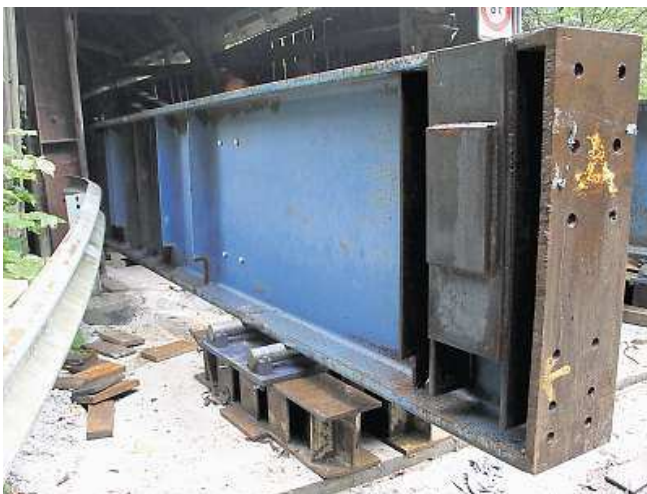
Präzision: Auf den provisorischen Einschublagern ruhen die Stahlträger, an denen die Brücke aufgehängt werden soll.
