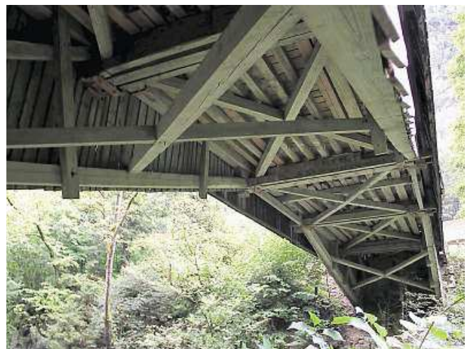
Wird ersetzt: Das Sprengwerk (Bogenkonstruktion), welches nachträglich eingebaut wurde, muss ersetzt werden.
